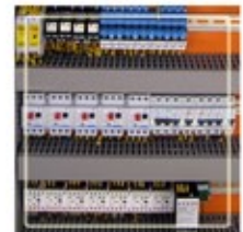
Elektrische Bauteile von erstklassigen, europäischen Herstellern
